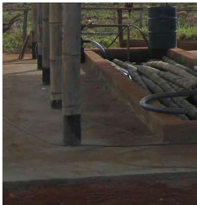
Figura 21 – Bambu impermeabilizado em contato com o chão.
