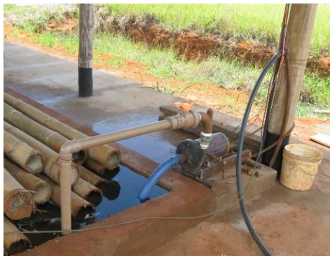
Figura 13 - Bomba para a circulação da água
